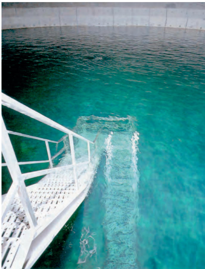
Außen- und Innenaufnahme Trinkwasserspeicher
